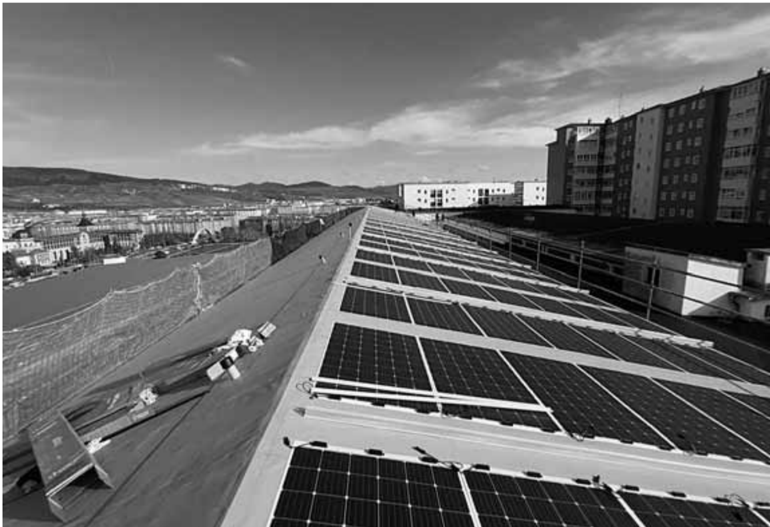
Paneles fotovoltaicos en el tejado de las instalaciones de Protección Ciudadana, en Pamplona.
